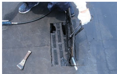
■ 下地補修 既存防水層：不具合部切開補修等 撤去下地面：ひび割れ補修、剥落・欠損補修等
