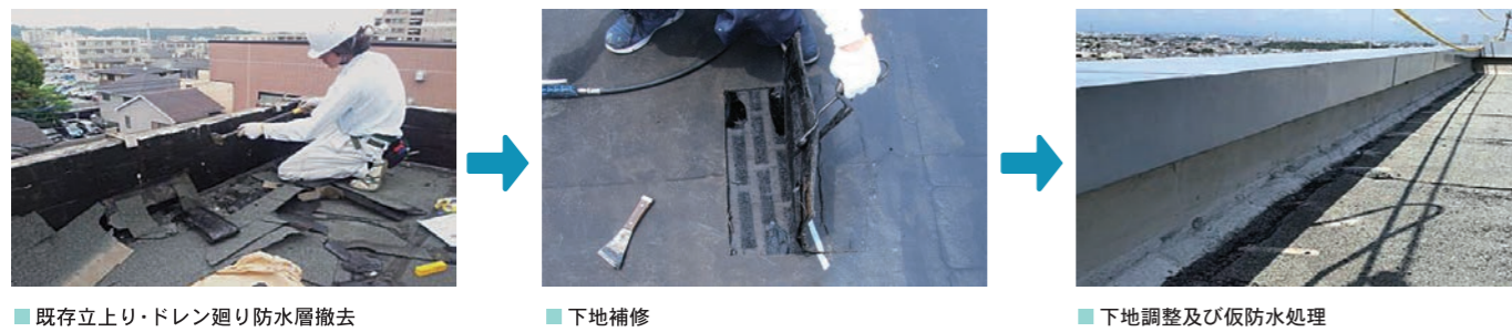
■ 既存立上り・ドレン廻り防水層撤去 (ハツリ機、ケレン棒等を用いる)
