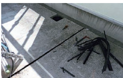
■ 既存伸縮目地材及びドレン回りの撤去 (ハツリ機、ケレン棒等を用いる)
